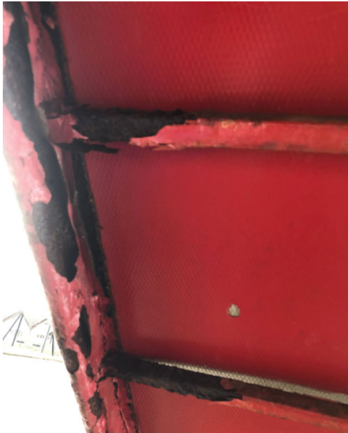
Rustskader på sklie
