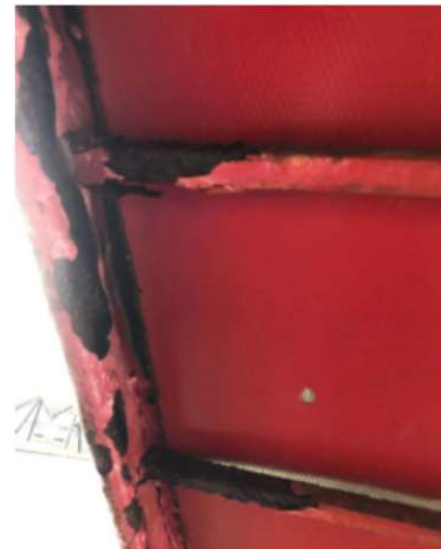
Rustskader på sklie
